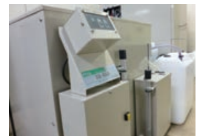
CTP 廃液の濾過装置
