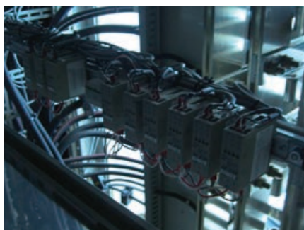
キュービクルに取付けた計測器
