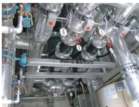
御殿場工場のボイラー
