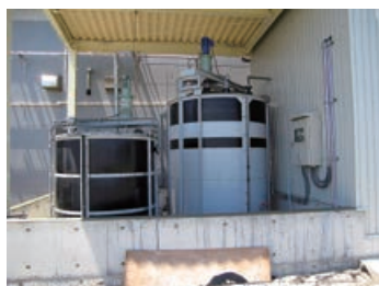
宇都宮工場の廃液タンク
