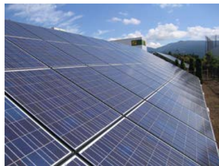
御殿場工場のソーラーパネル
